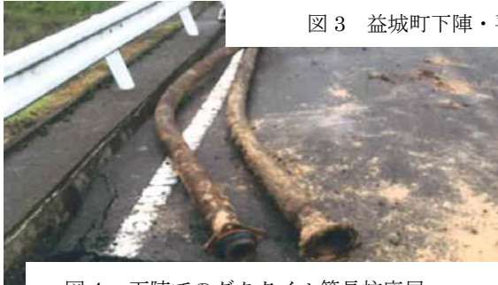
図4 下陣でのダクタイト管長柱座屈
