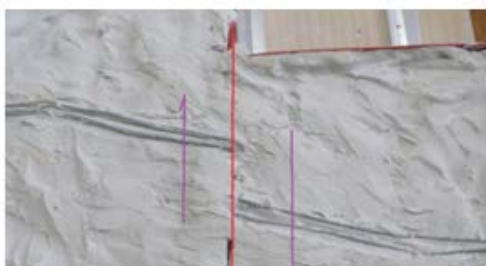
図 13 平田での直交交差角管路継手の破断
